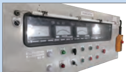
試運転測定器
